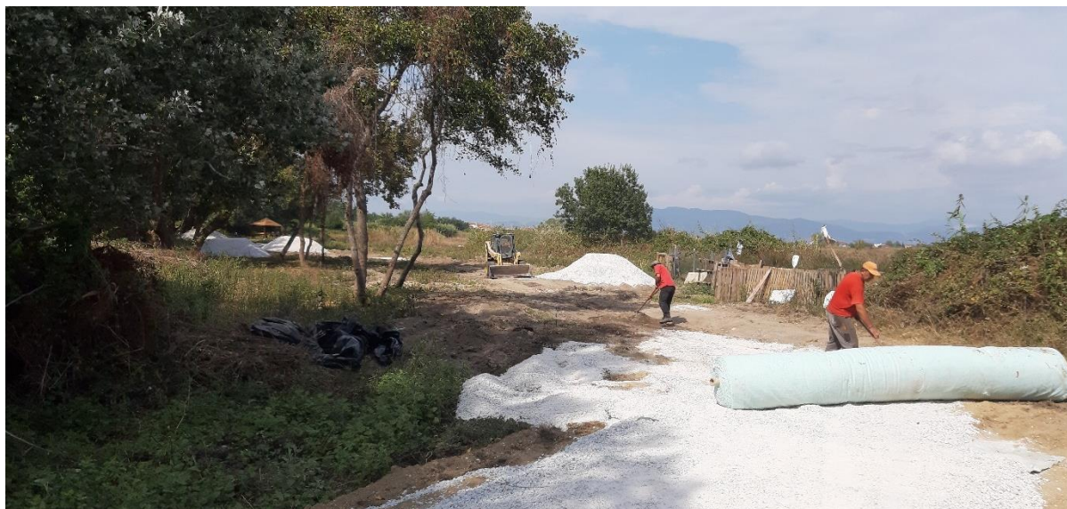
Εικόνα 7. Κατά την πρώτη επιθεώρηση το έργο ήταν σε εξέλιξη τ
